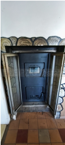
Befuerung Kamin im Flur
